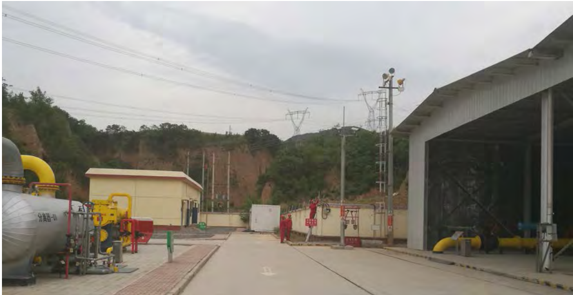
图 3-3 集气站现场照片
