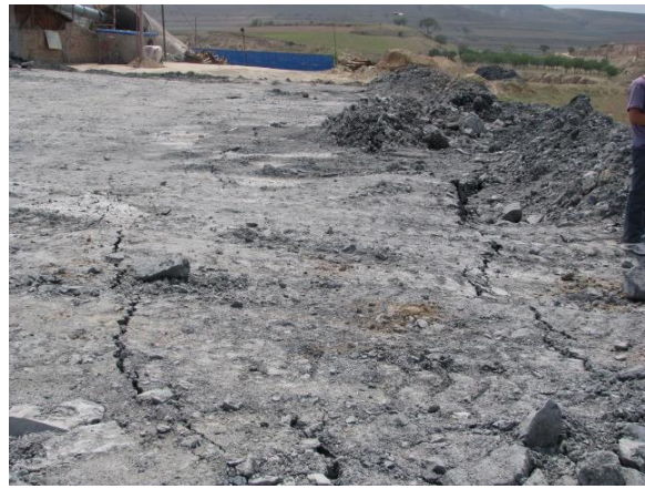
工业场地北侧 100m 处 X1 不稳定斜坡坡体后缘裂缝
