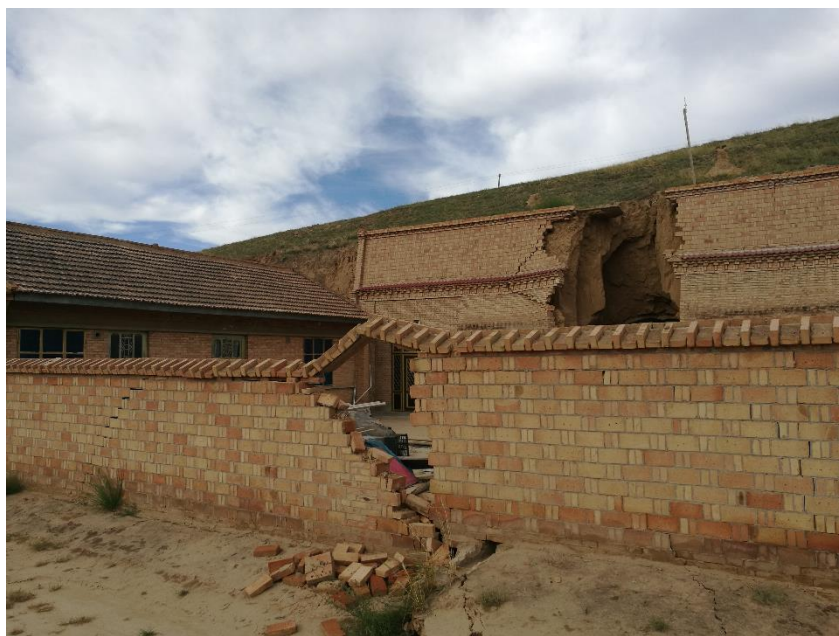
照片 3-4 工业场地西侧 2km 试采造成的地裂缝及房屋损毁
