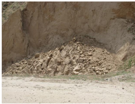
B1 矿区中部崩塌坡脚堆积体
