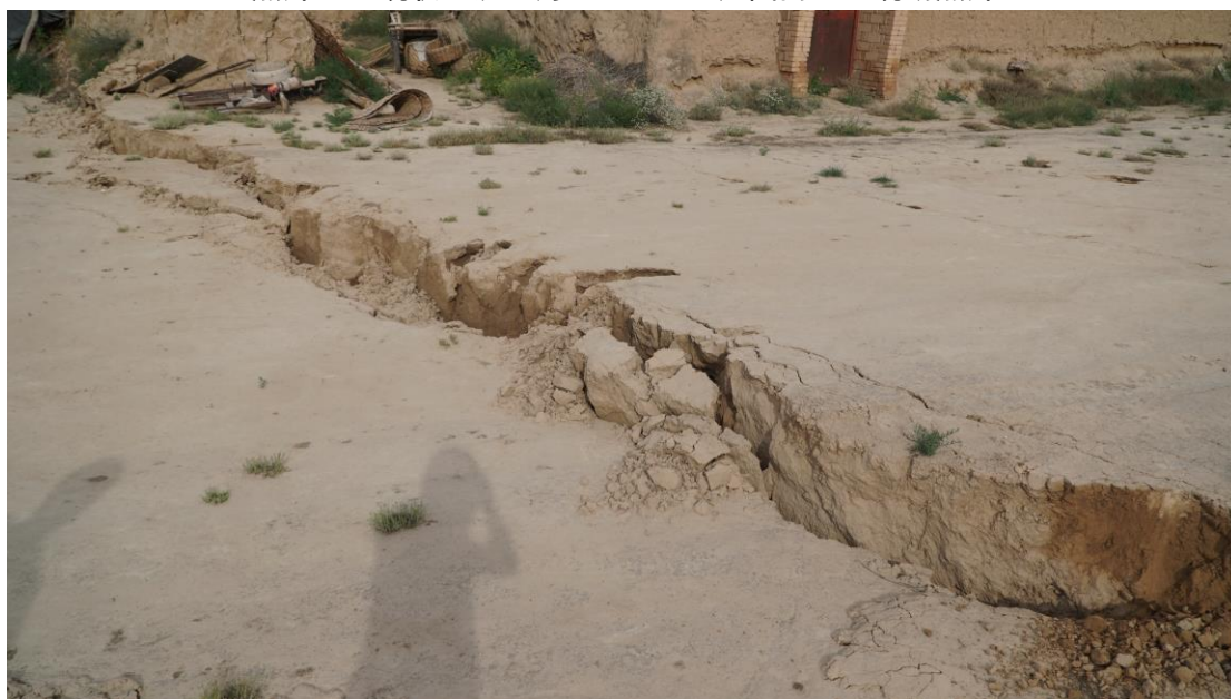
照片 3-9 现状水平形变影响区域
