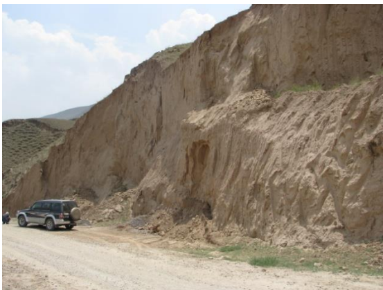
B1 矿区中部崩塌远景
