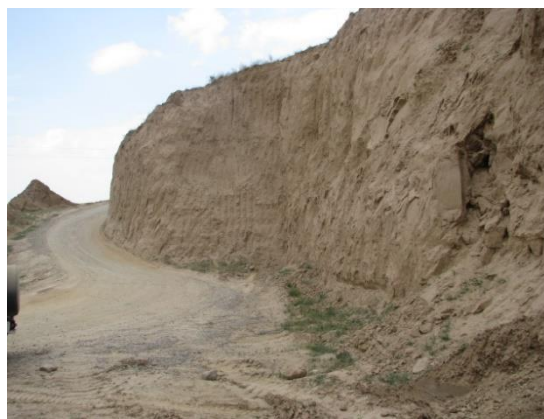
B2 矿区中部崩塌坡脚堆积体
