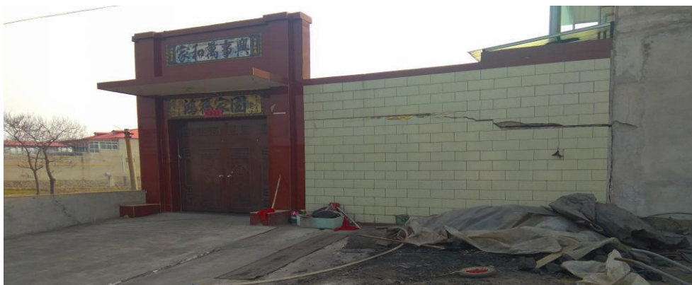
照片 3.2-1 房屋开裂
