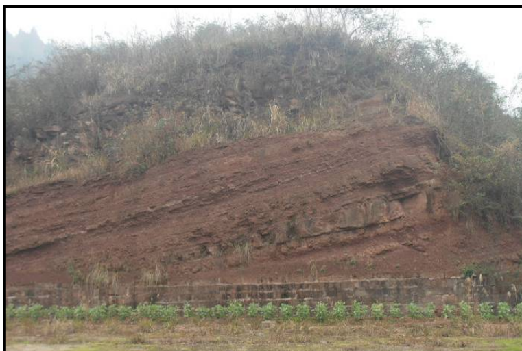
图 3-19 H3 滑坡隐患点现状图（未治理）
