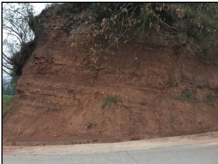
图 3-18 H2 滑坡隐患点现状图（未治理）
