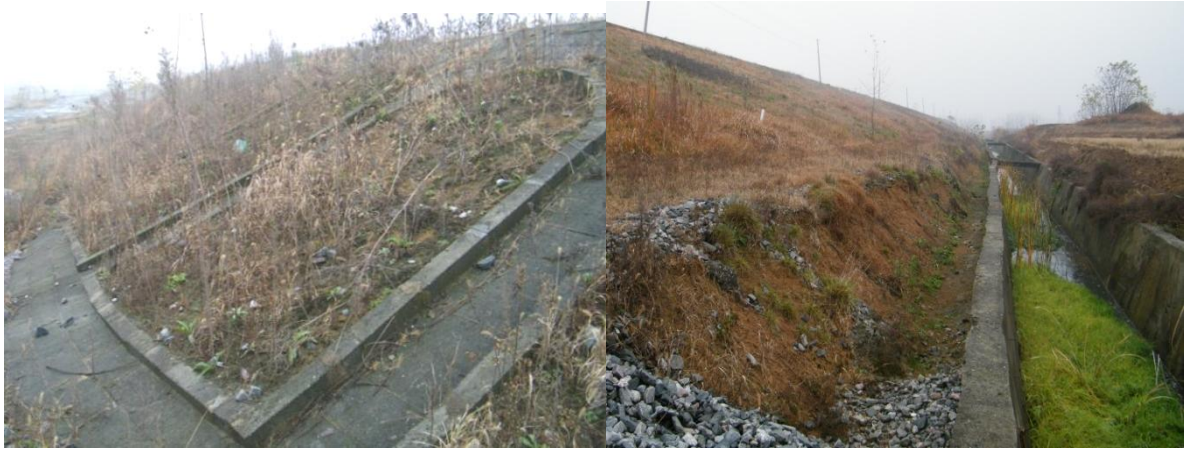
图 2-24 尾矿库坝体与边沟现状
