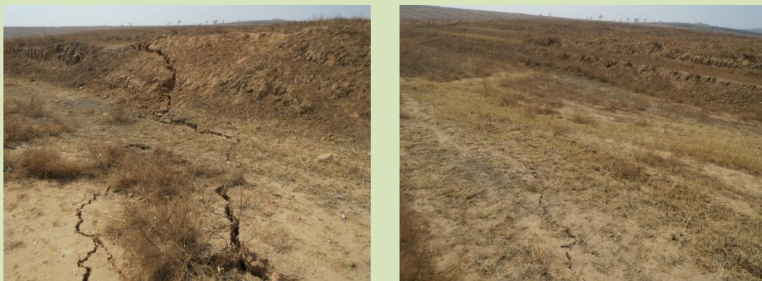
照片 2-34 局部已复垦地块因复采又产生了新的地裂缝
